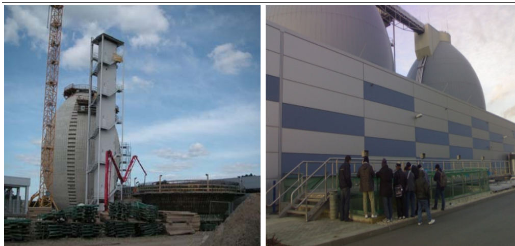
Imagen 31: Pieza central de una planta de co-digestión anaerobia para fangos de depuración con residuos biológicos (fuente de la imagen: INTECUS)
