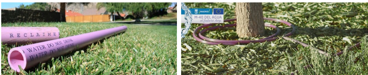
Abbildung 86: Beispiele für Verteilungssystemen für die Bewässerung urbaner Grünflächen mit aufbereitetem Wasser, links mit Warnhinweis auf dem Rohr, rechts separate Warnung (McCann et al., 2018; Madrid, 2023)
