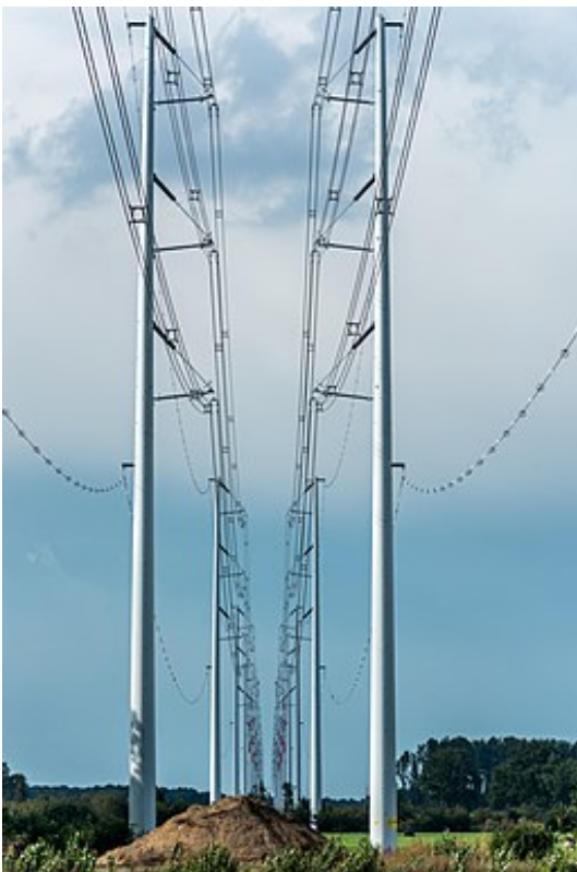
Abbildung 6: Wintrack-Kompaktmast in den Niederlanden
