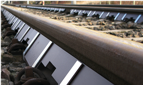
Abbildung 21: Schienenstegabschirmung an der Schiene
