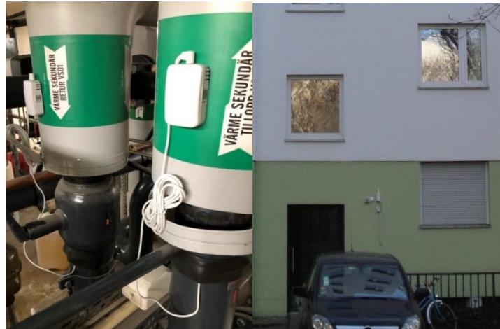
Abbildung 9: Temperaturfühler Vor- und Rücklauf bei Wetterprognosesteuerung (Bild links); Steuerbox rechts neben Türsturz (Bild rechts)
