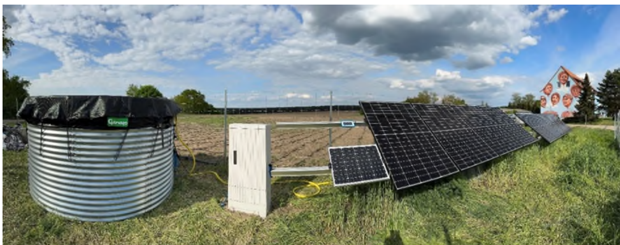
Abbildung 112: Foto des aufgebauten Bewässerungssystems im Reallabor. V.l.n.r.: Wassertank, Schaltschrank, Photovoltaikanlage. Hintergrund: Tropfschlauchbewässerung.
