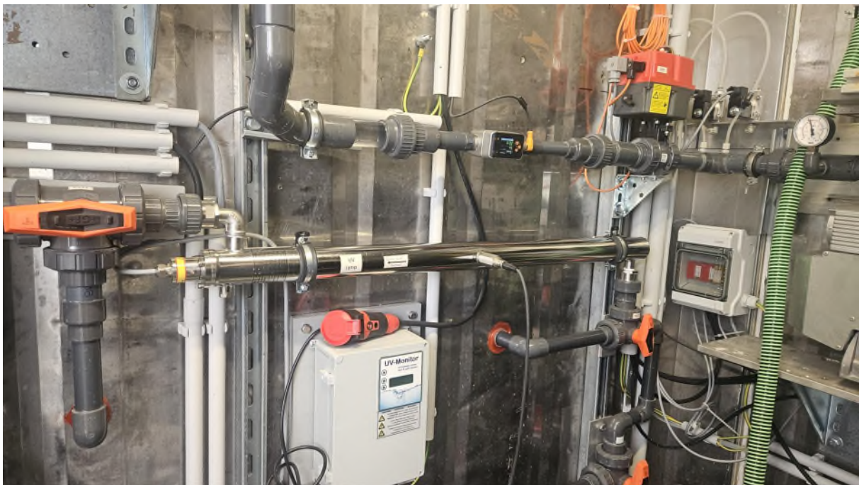
Abbildung 50: UV-Bestrahlungsreaktor als Bestandteil der halbtechnischen Versuchsanlage einschließlich der Steuer- und Energieversorgungseinheit.
