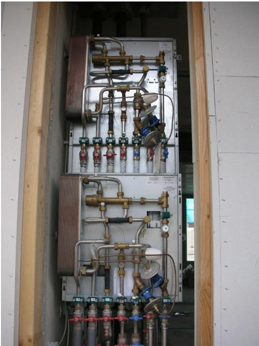
Abbildung 95: Zwei Wohnungsübergabestationen des Pilotvorhabens SNAB (Solare Nahwärme Ackermannbogen) mit großem Wärmeübertrager, eine von mehreren Ausführungsvarianten
