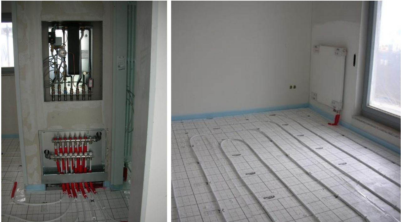
Abbildung 96: Wohnungsübergabestation über Heizverteiler Fußbodenheizung im Flurbereich einer Wohnung (links), Wandheizkörper, kombiniert mit Fußbodenheizung zur Rücklaufauskühlung (rechts)
