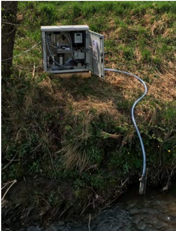
Abbildung 2: Automatischer Probenehmer am Fließgewässer installiert.
